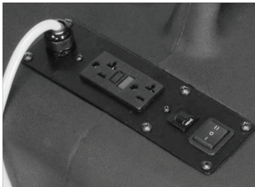
Interruptor de 2 posiciones y tomacorrientes conectados en cadena
